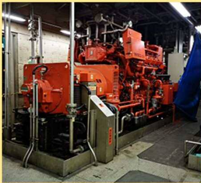
コージェネレーションシステム
